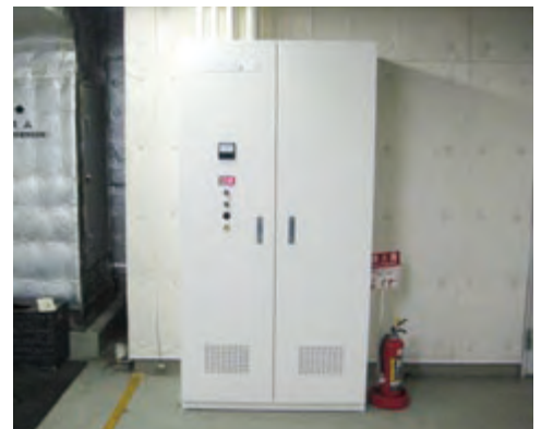
空調機インバーター盤
