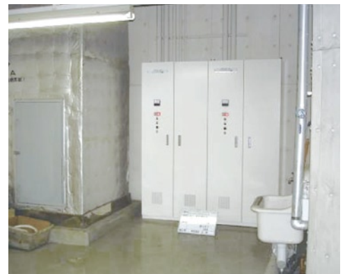
空調機用インバーター盤
