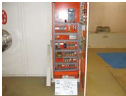
冷温水ポンプ(PH-3)用インバーター盤
