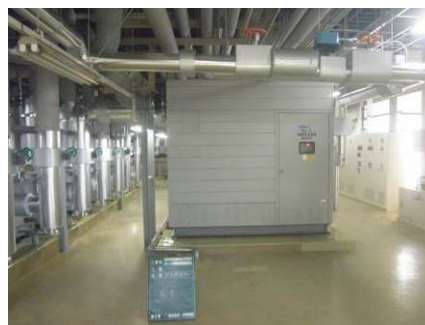
空調熱源設備更新（核融合研）
