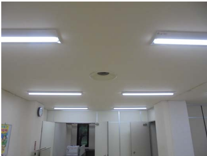
45m 観測棟の LED 照明 (天文台)
