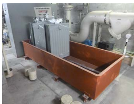
低濃度PCBを含有した絶縁油の入った変圧器の保管状況（明大寺地区エネルギーセンター棟）
