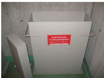
危険物倉庫内の金属製の箱の中に低濃度PCBを含有した油の入った容器を保管
