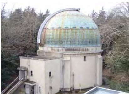
登録有形文化財ドーム屋根の劣化状況 (三鷹歴史館ドーム)
