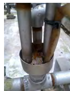
冷却水配管の赤水 (三鷹開発棟2号館)
