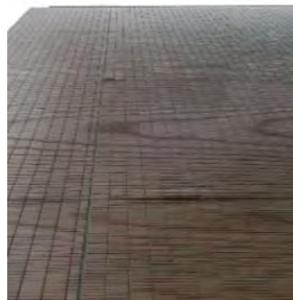
外壁タイル剥離
