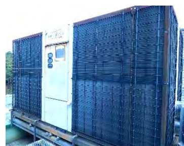
冷凍機本体腐食状況 (核融合)
