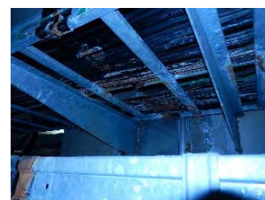
共同溝内ケーブルの経年劣化状況
