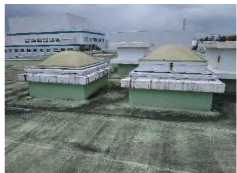
屋上防水経年劣化
