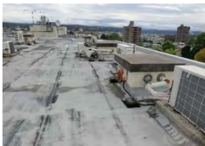
屋上防水経年劣化
