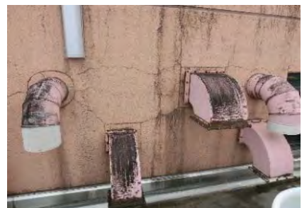
外壁クラック
