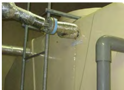
受水槽配管からの水漏れ (天文台)
