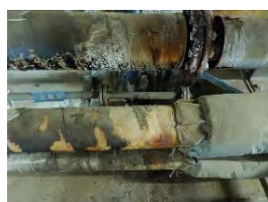
共同溝内蒸気管の経年劣化状況
