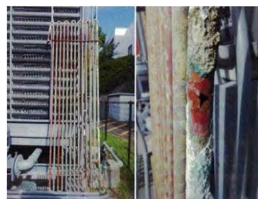
冷却塔内銅管腐食状況 (岡崎3機関)
