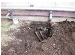
電力ケーブル地中埋設部破断 (三鷹重力波実験棟)
