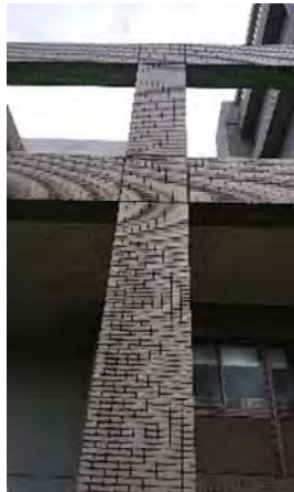
外壁タイル剥離
