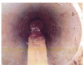
地中埋設排水管破損
