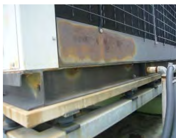
冷凍機本体腐食状況 (核融合)
