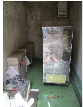
PCB 保管状況 (核融合科学研究所)
