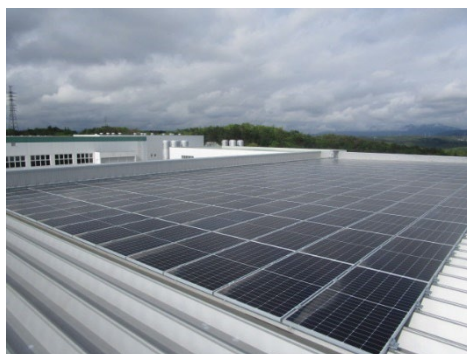
太陽光発電設備 （核融合科学研究所 計測実験棟屋上）
