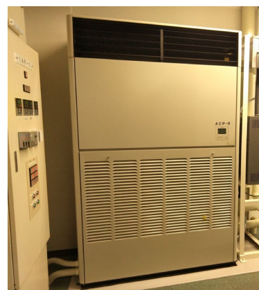
核融合科学研究所、制御棟、空調設備（更新）
