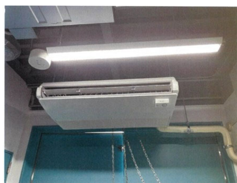
超高圧電子顕微鏡棟1階115B室空調機
