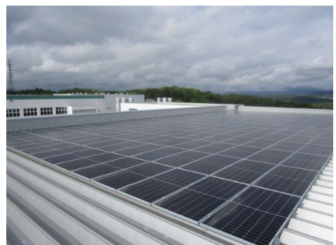
太陽光発電計測実験棟(核融合科学研究所)
