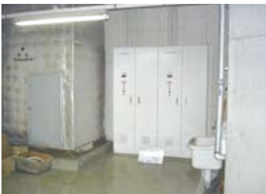
空調機用インバーター盤
