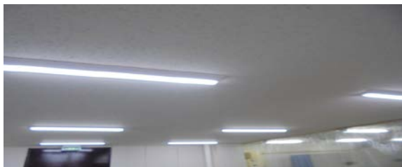
計算機室のLED照明（天文台）
