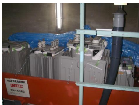
低濃度 PCB を含有した絶縁油の入った変圧器の保管状況（三島地区単身棟電気室）
