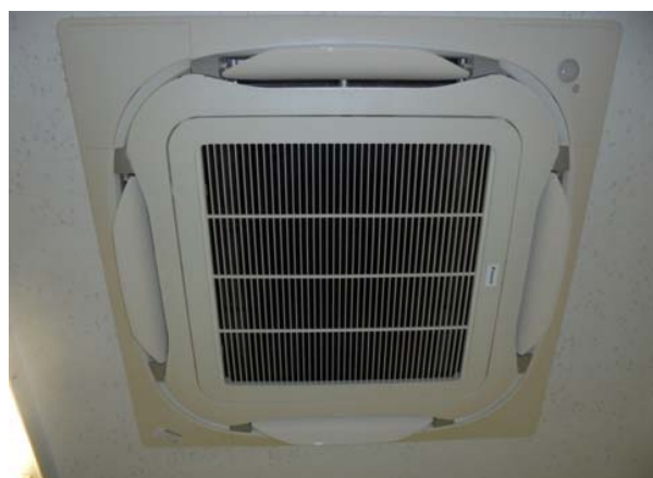
45m電波望遠鏡事務室の空調機 (天文台)
