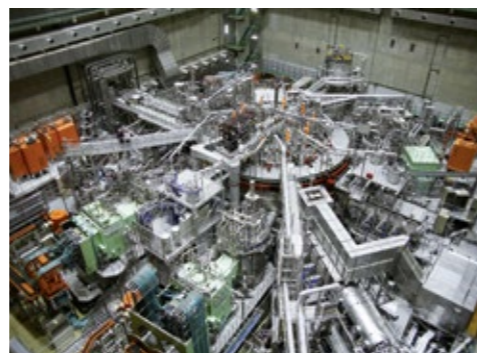
LHDの全景。直径13メートル、高さ9メートルのLHD本体の周りには、プラズマの加熱装置や計測装置が多数配置されています。
