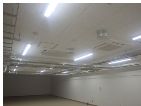
(明大寺)共同研究棟D棟の照明設備更新 (岡崎3機関)
