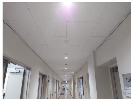
三鷹地区中央棟(北)廊下のLED照明(天文台)
